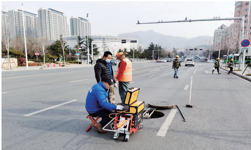
工作人员操作智慧排水检测设施。
