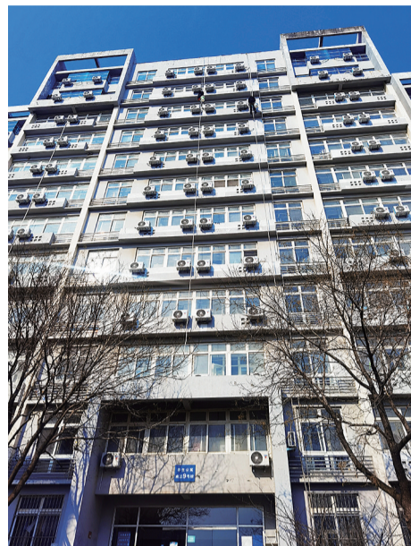
青科大宿舍楼安装的空调。学校供图
