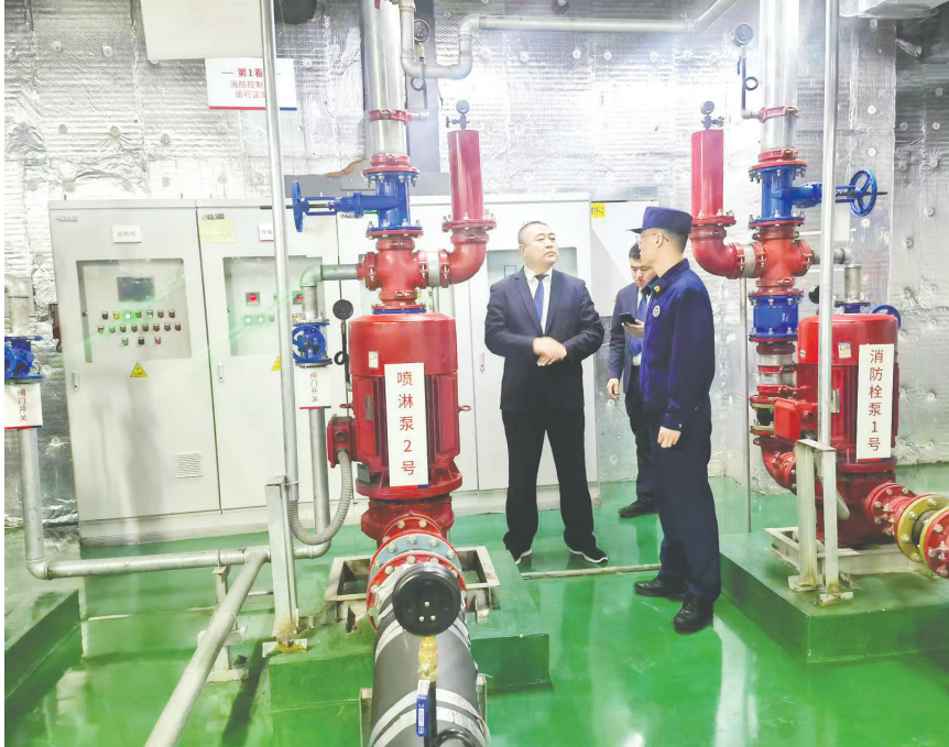
青岛高新区汇智桥路消防救援站的消防员在查看辖区单位的泵房。
