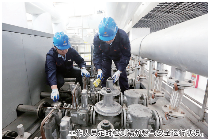
能源热电第三热力公司的工作人员正在实时监测管网运行情况。
