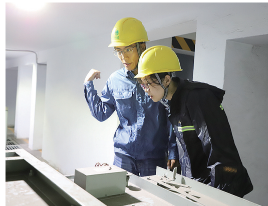
孙晓兰和同事在巡视变电站。
