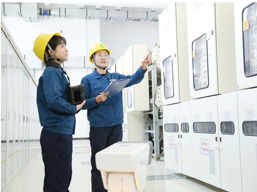
孙晓兰和同事正在对变电站进行巡视。
