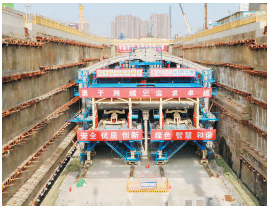
我国首个全方位装配式地铁车站——青岛地铁6号线一期可洛石站
