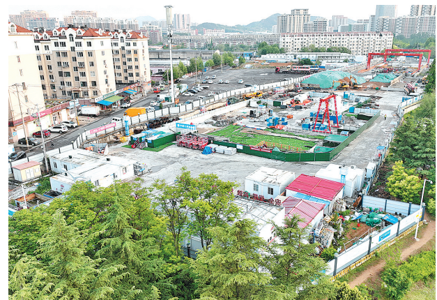
■地铁2号线二期土建工程全面收尾，向年底通车冲刺。 杨志文 摄
