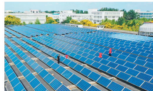
国网青岛供电公司员工服务企业园区屋顶光伏发电项目建设。
