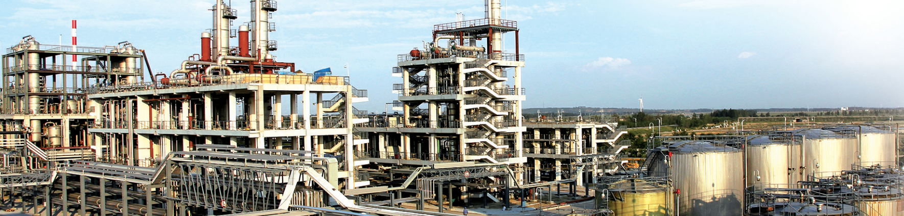
■青岛海湾集团新河产业园区国内领先的双乙烯醇生产线。
