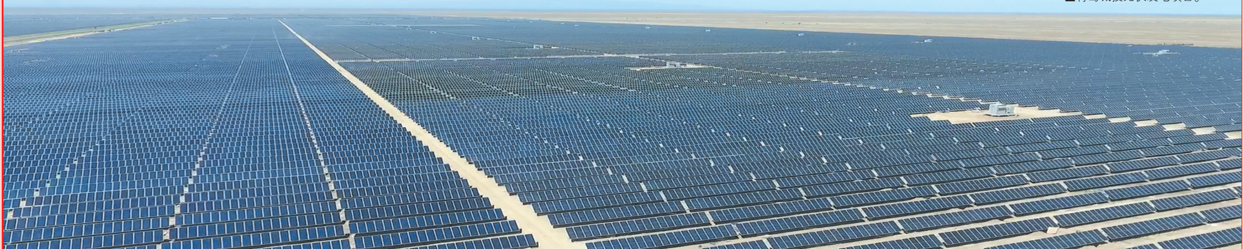
■青岛城投光伏发电项目。
