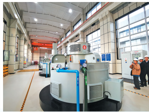
■棘洪滩水库泵站内机器轰鸣。吴帅 摄
