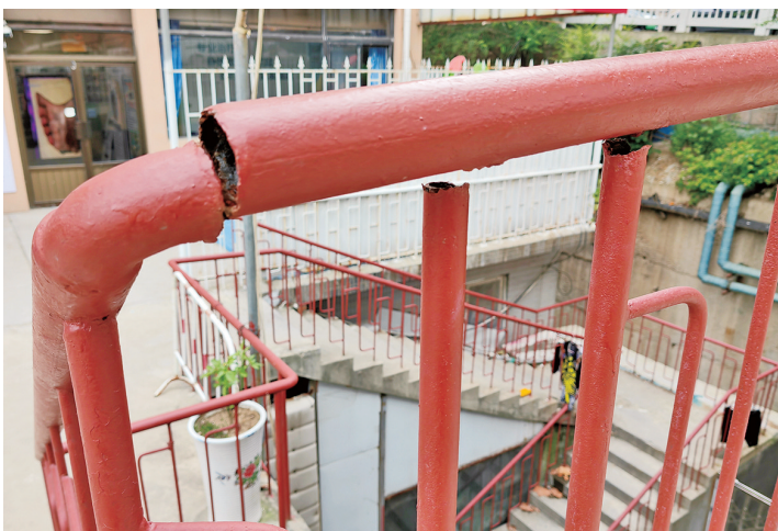
■市南区天台一路一处铁栏杆年久失修,锈蚀严重。
