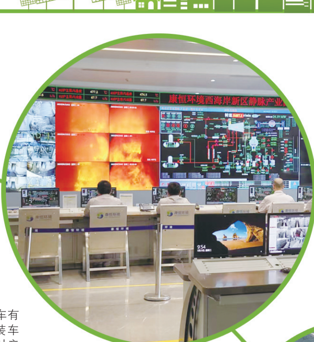
■静脉产业园中央控制室，可完成对静脉产业园的全方位智慧管控。梁超摄
