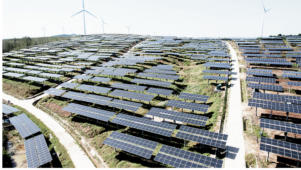
西海岸新区胶河上上农业40兆瓦光伏发电项目。
