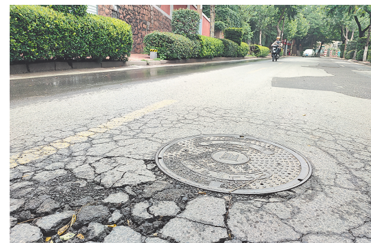
■“古力”井口周边的路面存在破裂和下沉的情况。
