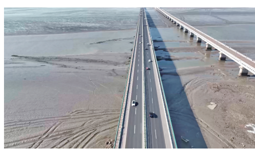
青兰高速双埠至河套段女姑口跨海特大桥改造前。
