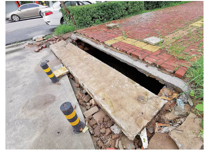
■城阳区玉霞路人行道排水渠盖板脱落。
