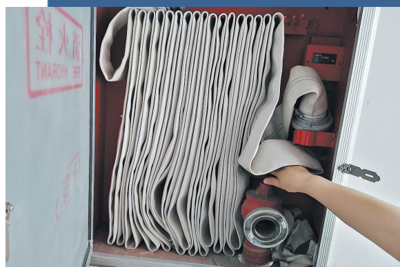
■市民旋转市南区天虹大厦内的消防栓阀门开关,放不出一滴水。
