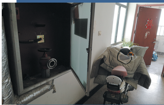
■西海岸新区北下庄社区居民楼电梯厅内的消防栓没有水带。
