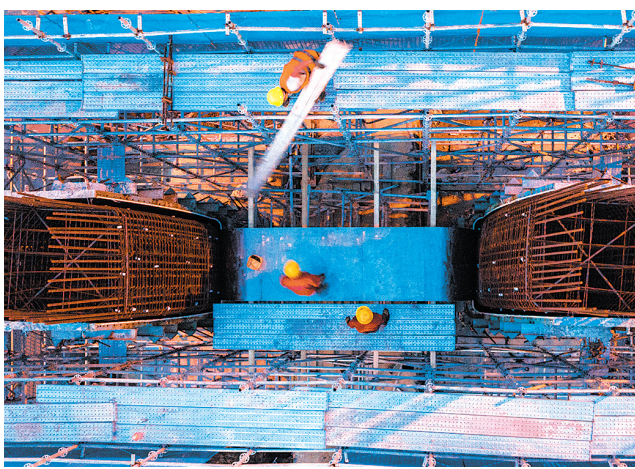
辽阳路快速路(福州路-海尔路段)施工现场,工人们正在紧张施工。 刘栋 摄
