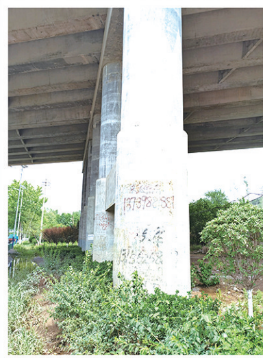
■即墨区龙青高速桥墩上小广告“久治不愈”。
